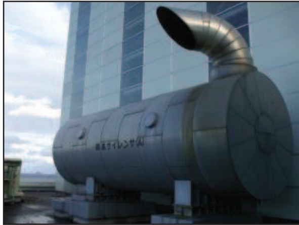
図1 ディーゼル発電機 排気管
