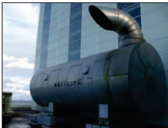
図 2.3-8 ディーゼル発電機 排気管
