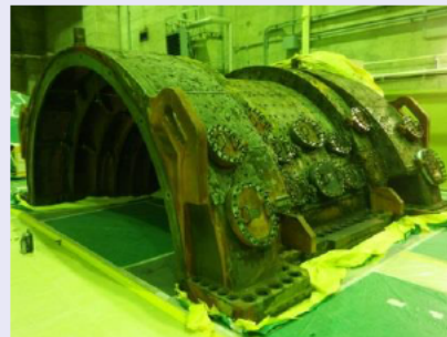
低圧内部車室
