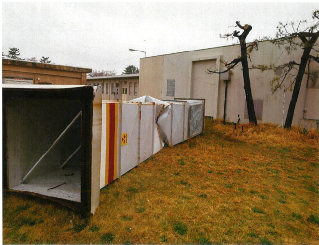
排気筒 倒壊写真
