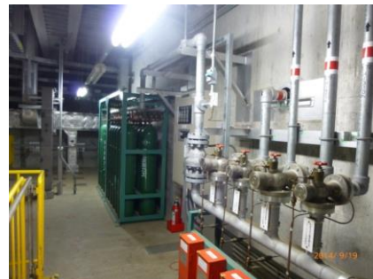
二酸化炭素消火設備
