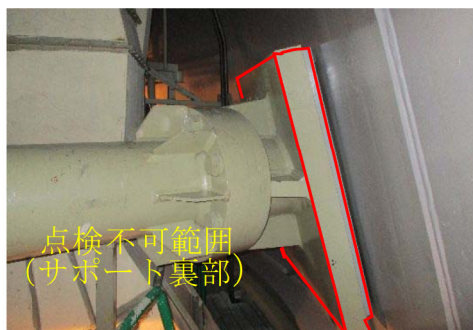
図 5. 2 干渉物等で接近が困難であり今回定めた目視試験条件が確保できない範囲（代表例）
