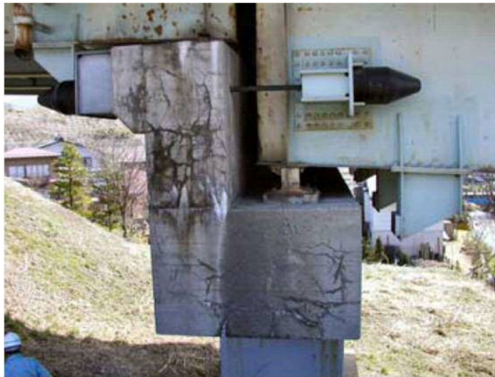
図 3. 2. 4-2 実構造物における膨張ひび割れ（亀甲状）の事例 5)
