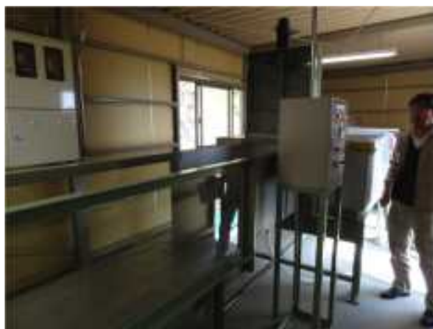
図 9-7 急開ゲート及び操作盤
