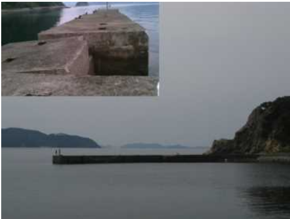
図 7.11 : 竜王池周辺の突堤および一部破壊された部位 (左上)
