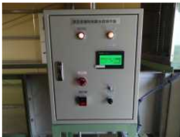
図 9-8 急開ゲート操作盤
