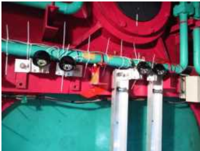
写真 4.1.3 照明（ハロゲンランプ）設置状況
