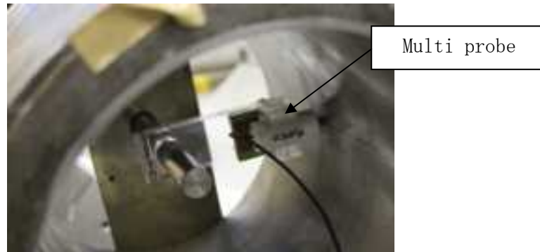
図 3. 2. 3-321 配管内のマルチプローブの状態
