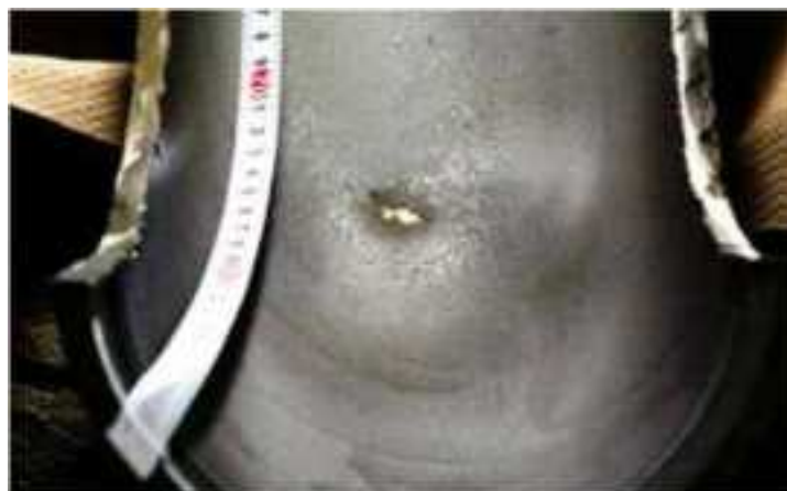
図2.1.5-4 損傷配管の内面と外面
