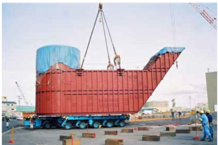
図 2.1.7 原子炉下部キャビティ室構造体
