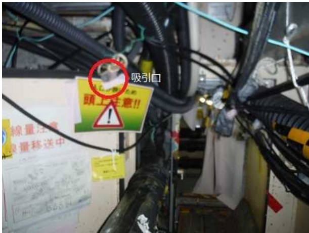
【写真 3】1号機タービン建屋1階ヒータールーム北側入口手前の吸引口(サンプリング箇所)
