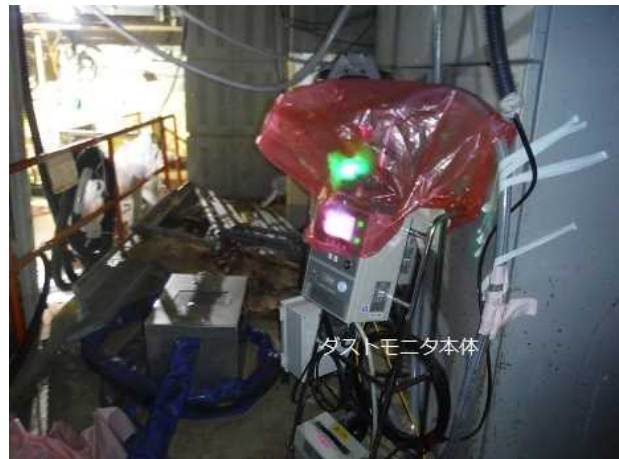
【写真2】1号機タービン建屋1階ヒータールーム北側入口手前に設置されているダストモニタ本体
