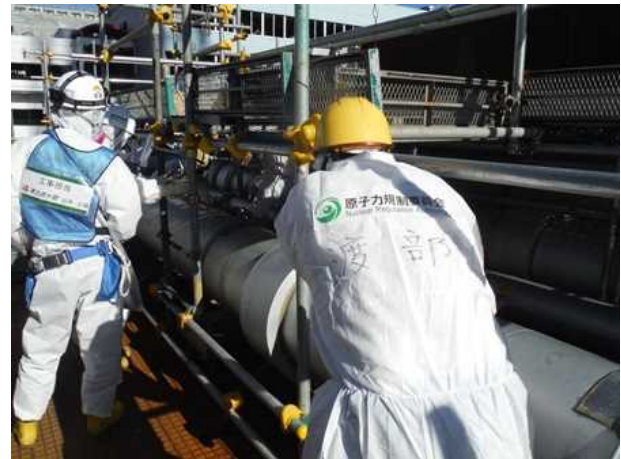
【写真 6】1号機R/B付近の西⑤ブロックでの凍結管入口弁の開操作状況の確認。
