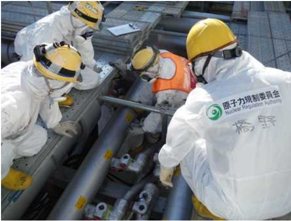
【写真 3】4号機R/B付近の西⑦ブロックでの凍結管入口弁の開操作状況の確認。
