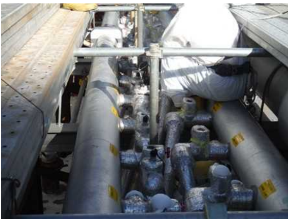
【参考写真1】凍結管ヘッダー入口弁、出口弁
