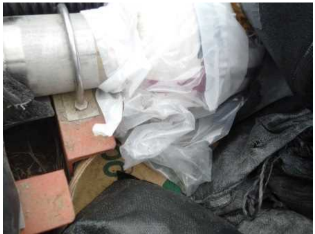
【写真 4】当該フランジ部。吸水材及びビニールの上からビニール袋が被されている。また、その下にはアクアブロックが設置されている。
