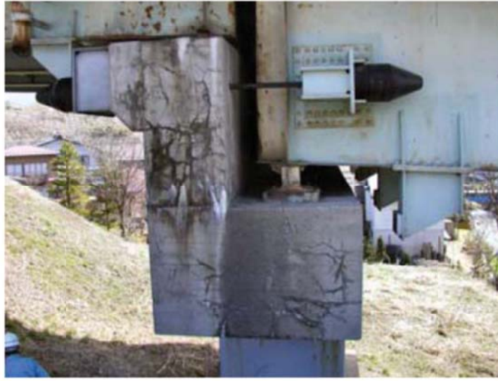
図3. 2. 4-2 実構造物における膨張ひび割れ（亀甲状）の事例 6)
