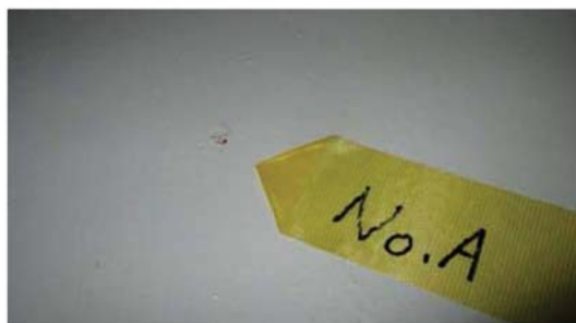
フロー②と判断した塗膜の劣化
