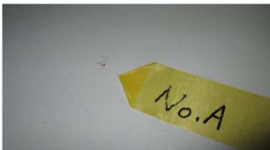
フロー②と判断した塗膜の劣化
