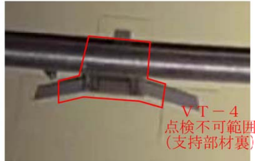
図5.2 高所等で接近が困難でありVT-4の要求条件が確保できない範囲
