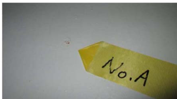
フロー②と判断した塗膜の劣化
