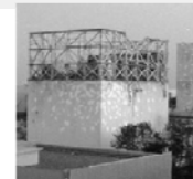
破壊された1号機原子炉建屋
