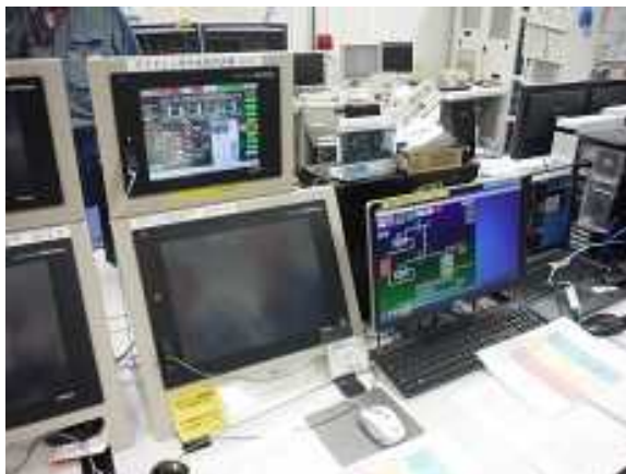
【写真 1】免震重要棟集中監視室のサブドレンシステム。
