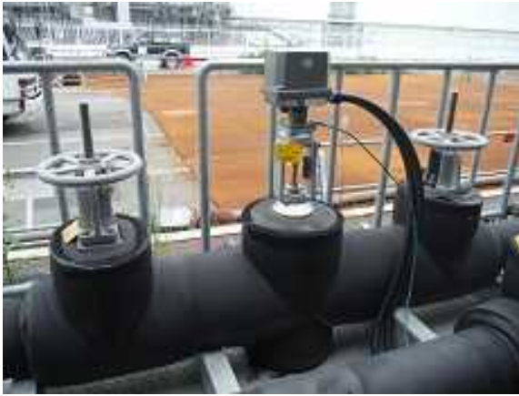
【写真 3】5号機南側排水ライン下流側流量調整弁 A(中央)。
