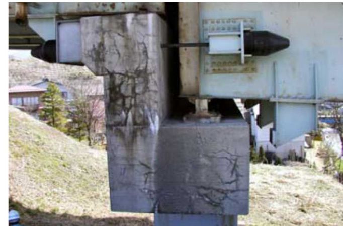
橋脚に発生したアルカリ骨材反応による網目状のひび割れの例
