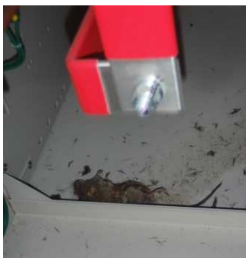
(こげ痕の真下の床面に小動物の死骸を確認)
