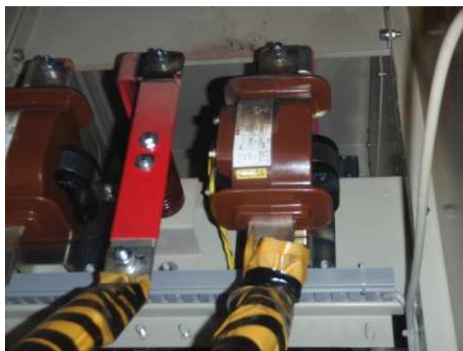
(盤内部の端子及び天井部にこげ痕を確認)
