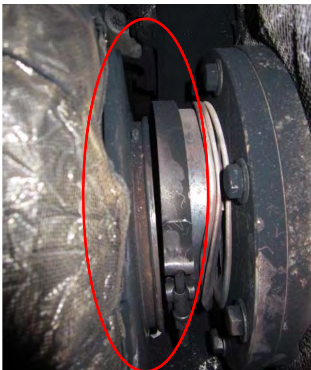
フランジおよび伸縮継手が外れている
