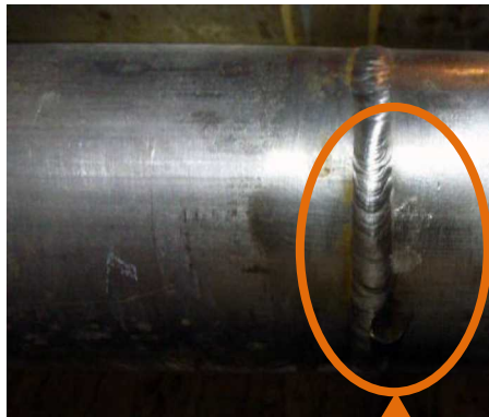
当該配管溶接部近傍
